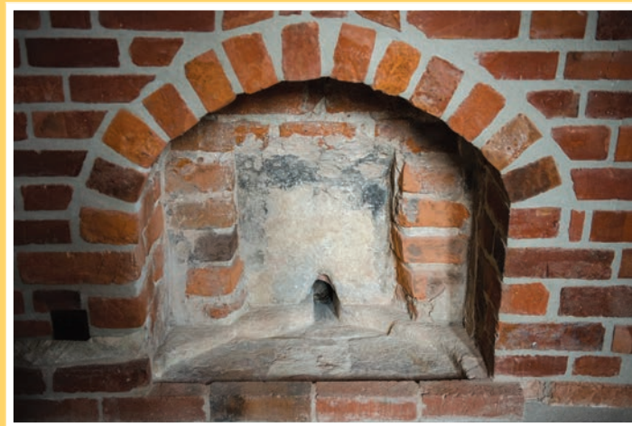
Otvor pro odvádění vody
