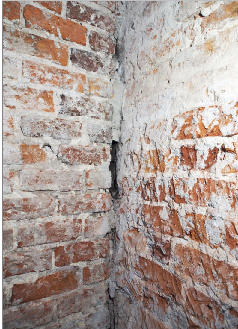
Ilustracja 41. Rozwarstwienie narożnika północno-zachodniego kościoła widoczne nad poziomem empy. Fot. P. Filipowicz, 2019
