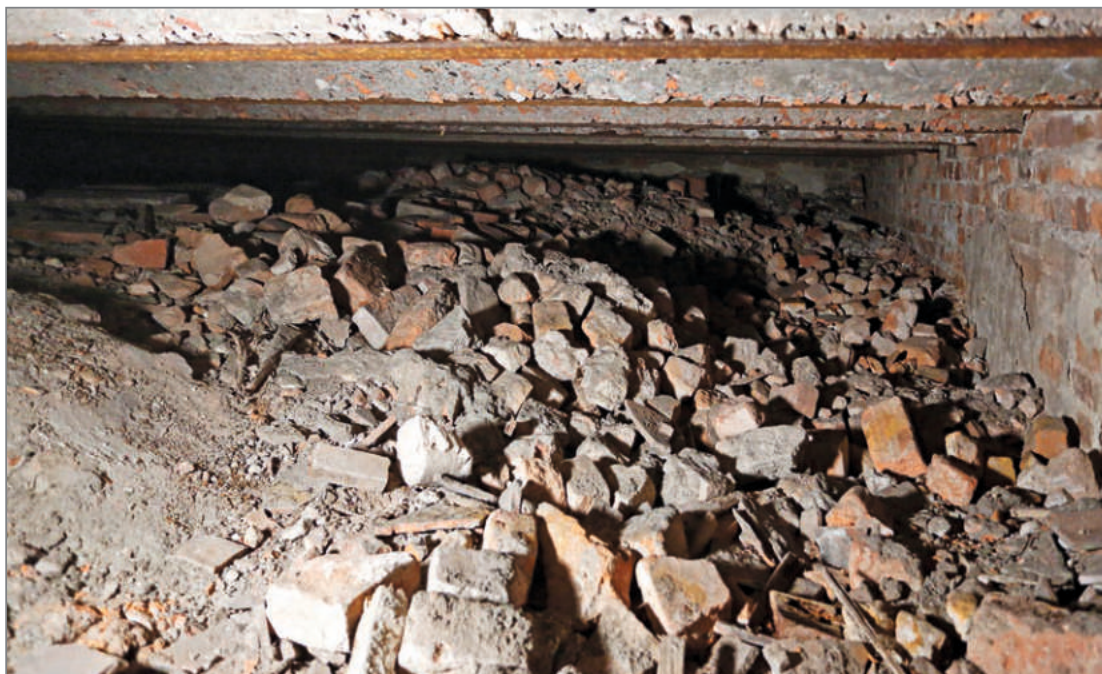
Ilustracja 29. Przestrzeń strychowa nad dużą zakrystią. Widoczne zagruzowanie pach sklepiennych cegłą, ceramicznymi dachówkami i fragmentami elementów kamiennych. Fot. A. Nowak, 2019
