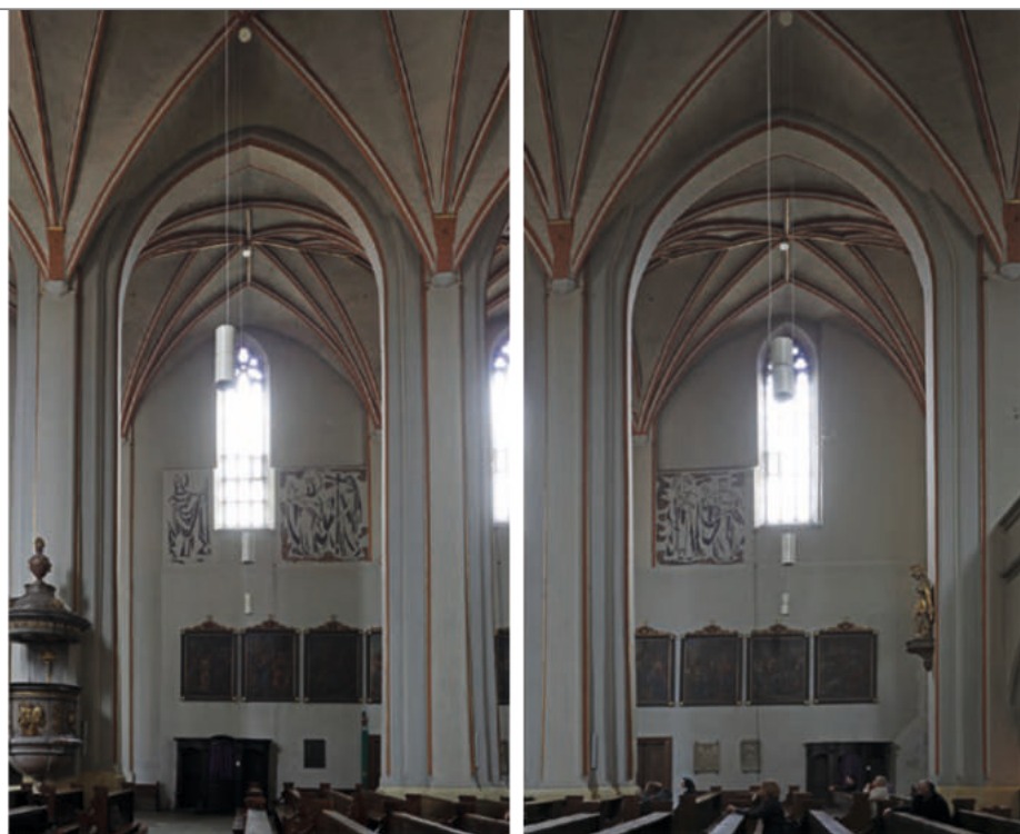
Ilustracja 15. Ściany nawy południowej z filarami międzynawowymi pokryte tynkami z lat 60. XX w., stan przed konserwacją. Fot. A. Nowak, 2017
